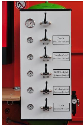
Panneau de commande des pompes
